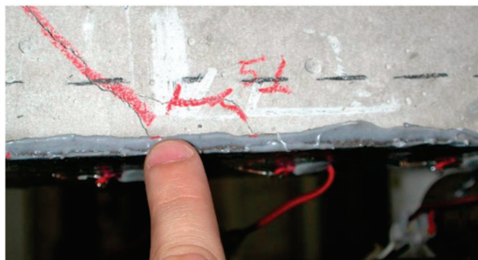
a) formação da fissura
