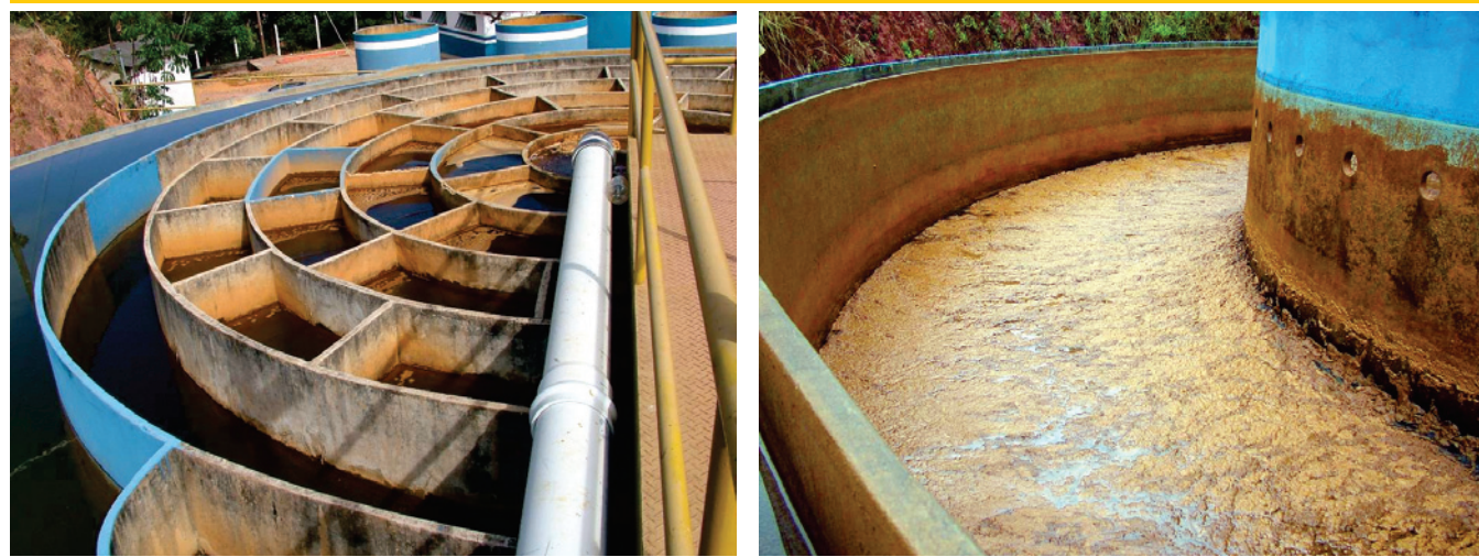
Figura 1 - Estação de Tratamento de Água de Santana do Paraíso-MG
