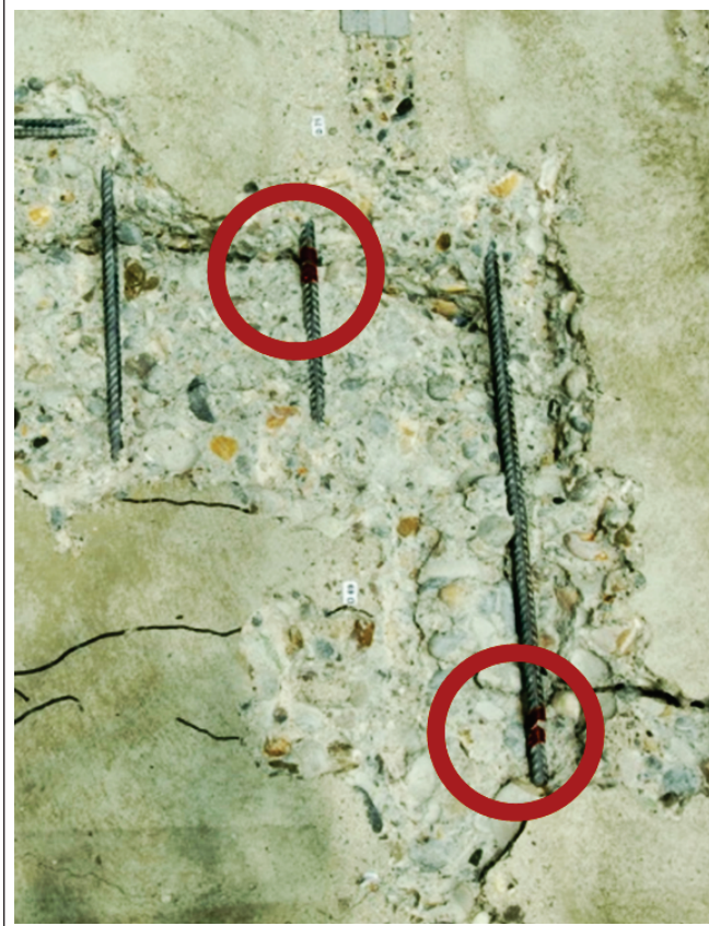
Figura 1 – Resultado de inspeção em viga de concreto armado após ruptura em teste de fadiga
